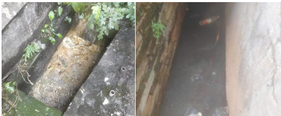
图 3.1-2 管网及排水沟渠淤积堵塞现状图片
